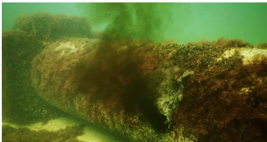
Nymölla pappersbruks nya tub som med jämna mellanrum pumpar ut föroreningar i Hanöbukten. Tuben är över 2 km lång.
